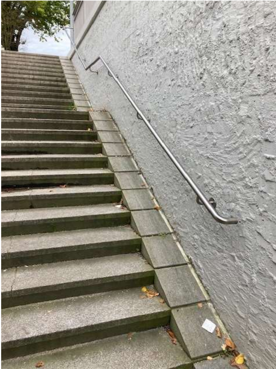
Bild 1: Schiebehilfe der Unterführung Maltesterplatz - Kaiser-Wilhelm - Ring – Max Reger-Gymnasium mit Keillösung
